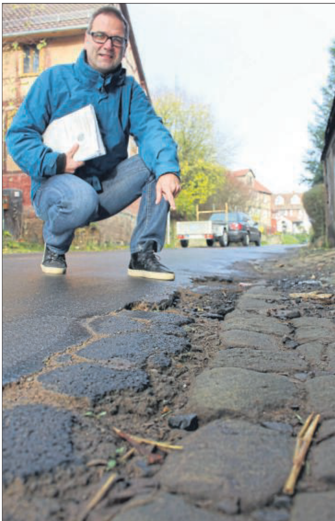
Löcher in der Straße: Jörg Emilius, Leiter des Spangenger Bauamts, zeigt die Löcher in der Ortsdurchfahrt Landefeld. Der Randbereich besteht noch aus Kopfsteinpflaster, das mehr als hundert Jahre alt ist.
